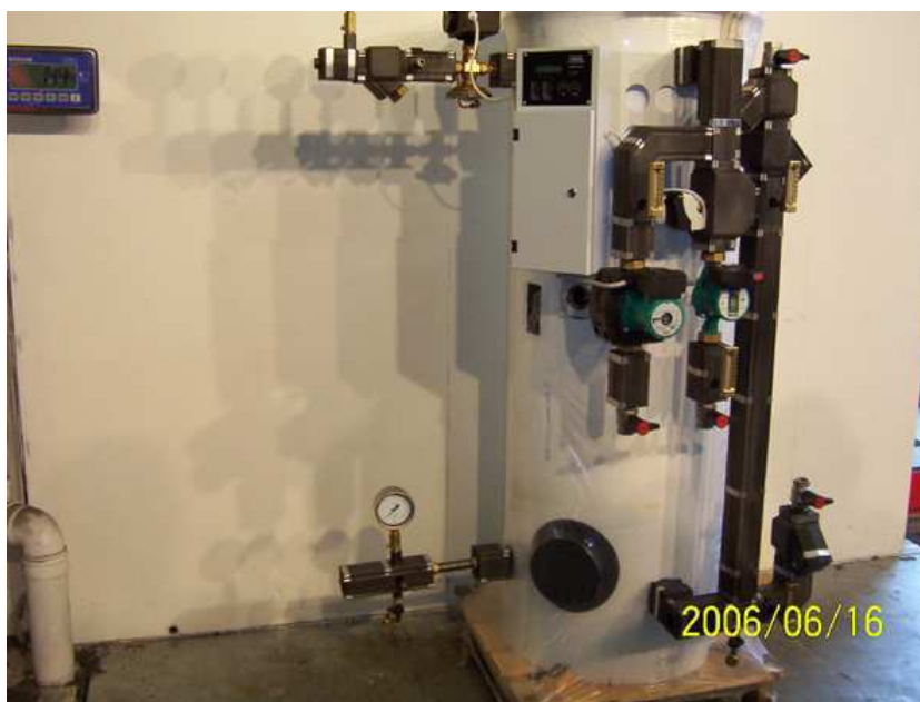
Wärmeübergabestation bestehend aus Pufferspeicher, Pumpen, Regelung, Wärmemengenzähler
