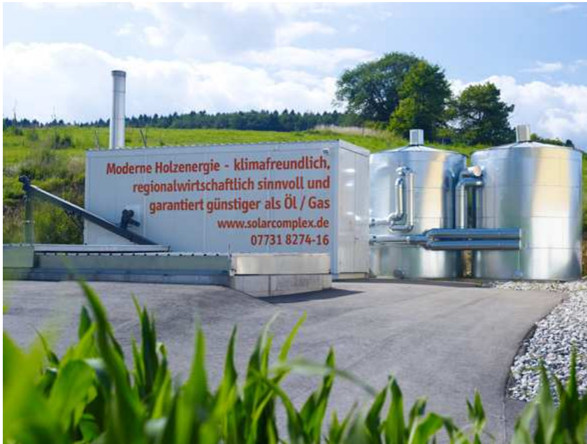
Hackschnitzelbunker (Vordergrund) und Heizzentrale im Container (Hintergrund)
