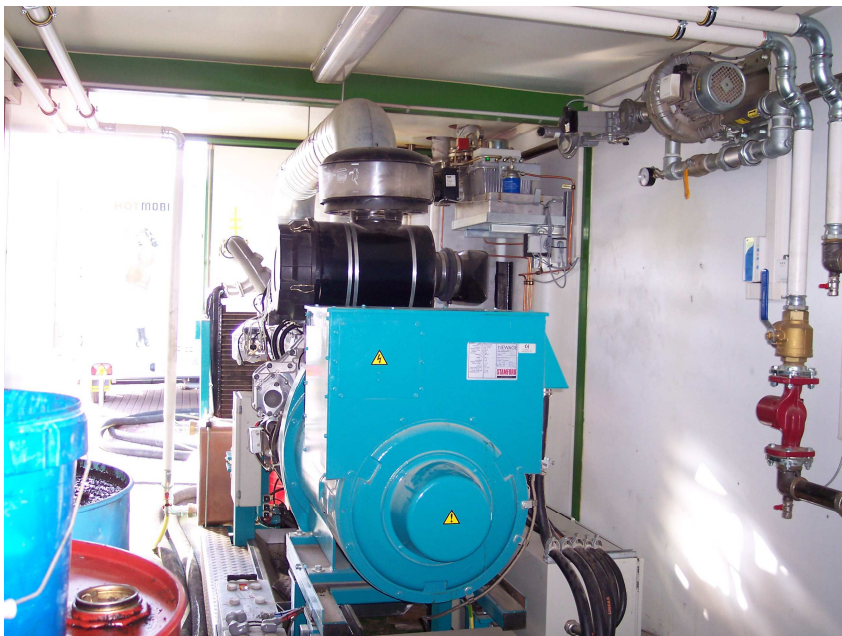
Im BHKW (Blockheizkraftwerk) werden Strom und Wärme aus Biogas erzeugt.
